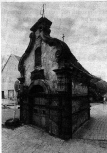
Kaple sv. Anny v Lokti, havarijní stav v květnu 1987
